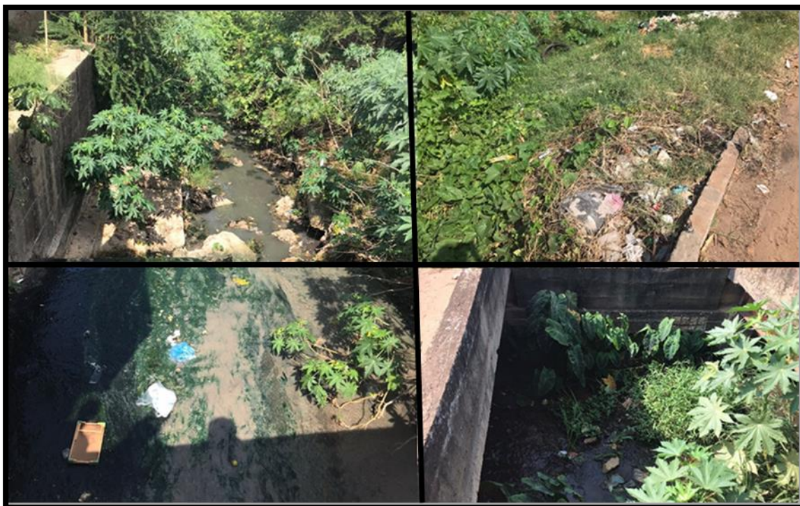
Figura 35: Canal canalizado e retificado, com resíduos sólidos
